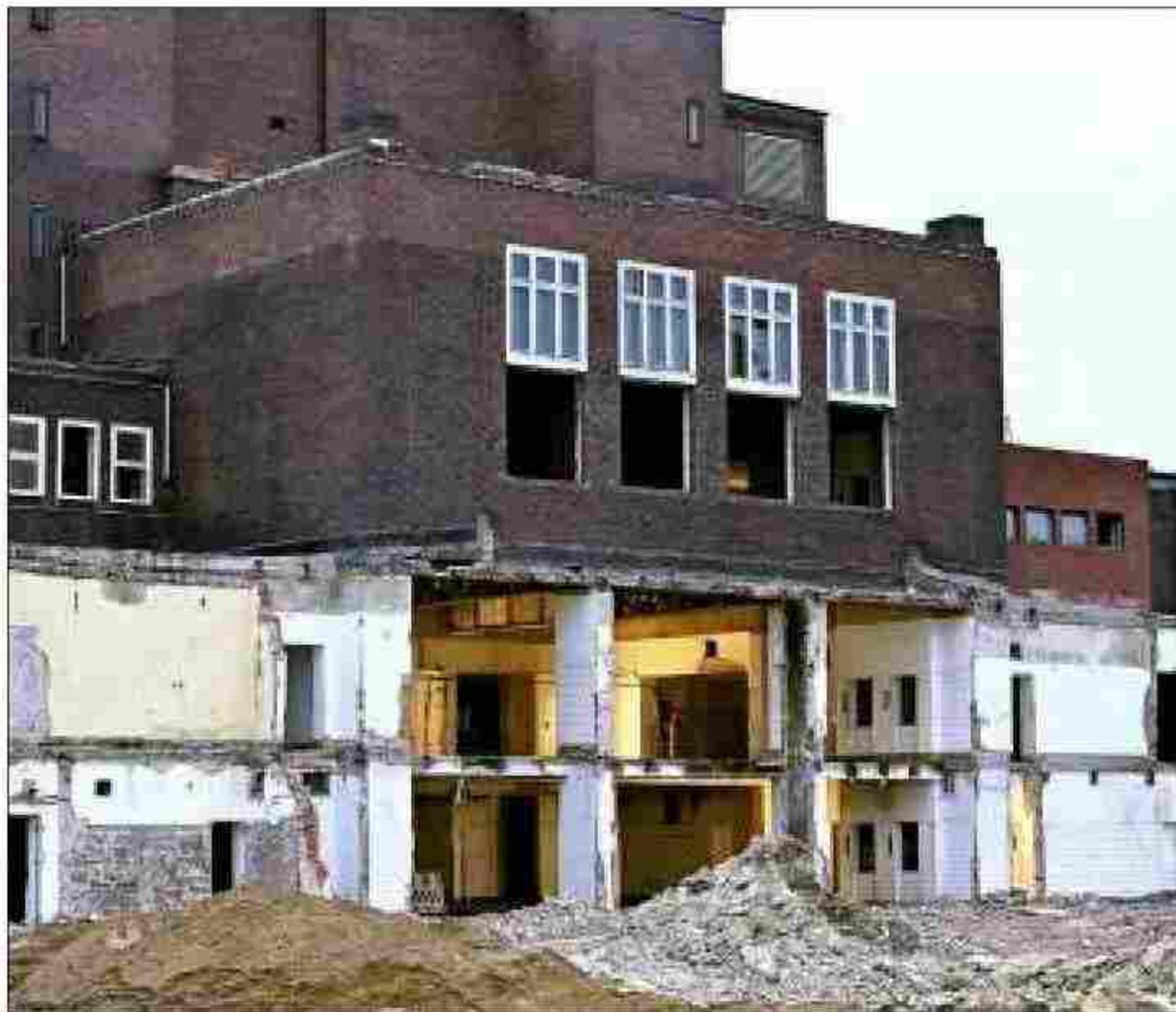
Die Rück- und Rohbauarbeiten an der Stadthalle werden im Wesentlichen das ganze Jahr in Anspruch nehmen.
