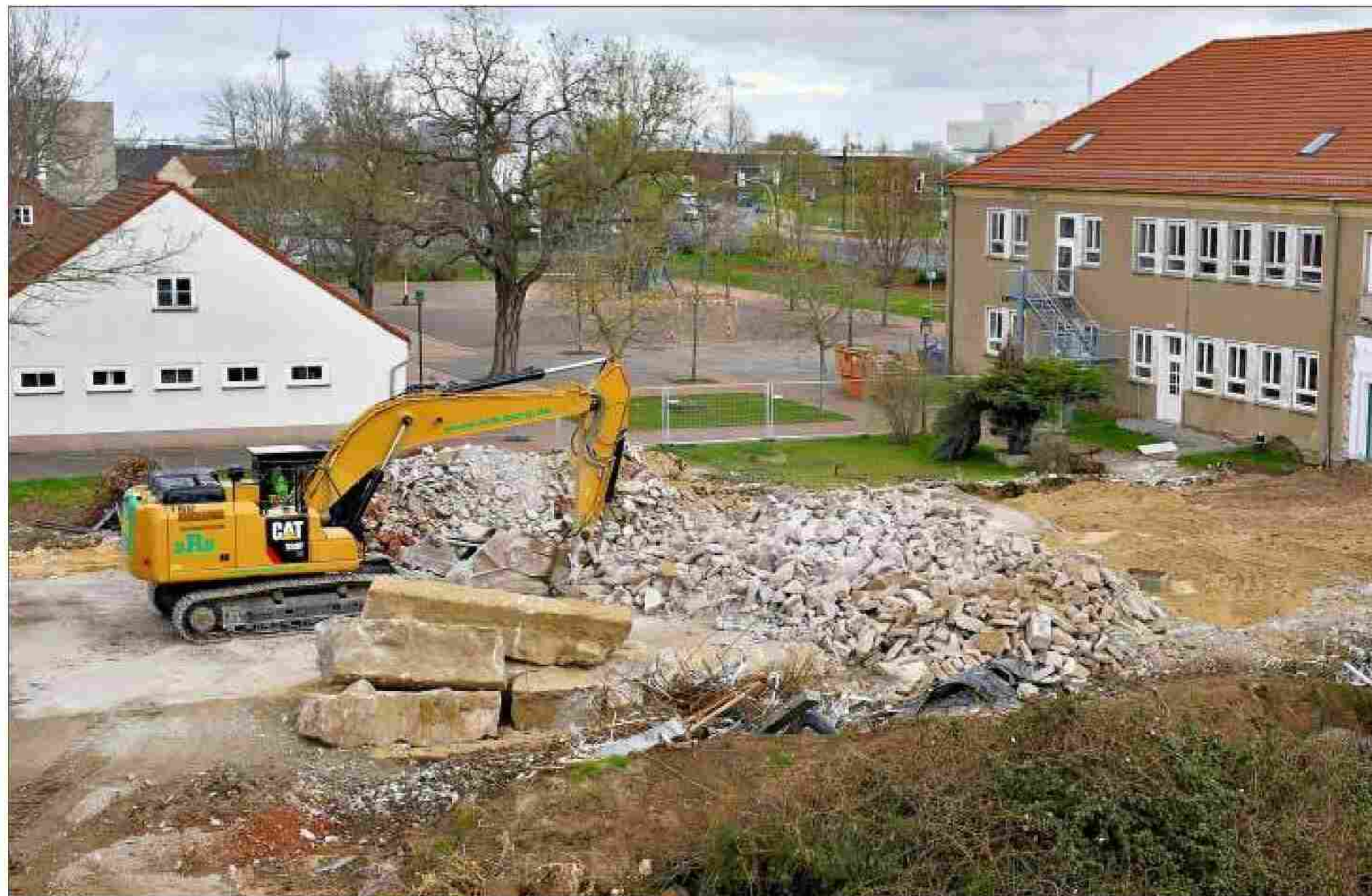
Die ehemalige August-Bebel-Schule in Rothensee wird derzeit abgerissen. Sie macht Platz für einen Neubau für den Hort der benachbarten Grundschule. Wann dafür Baustart sein wird, ist derzeit noch unklar.
