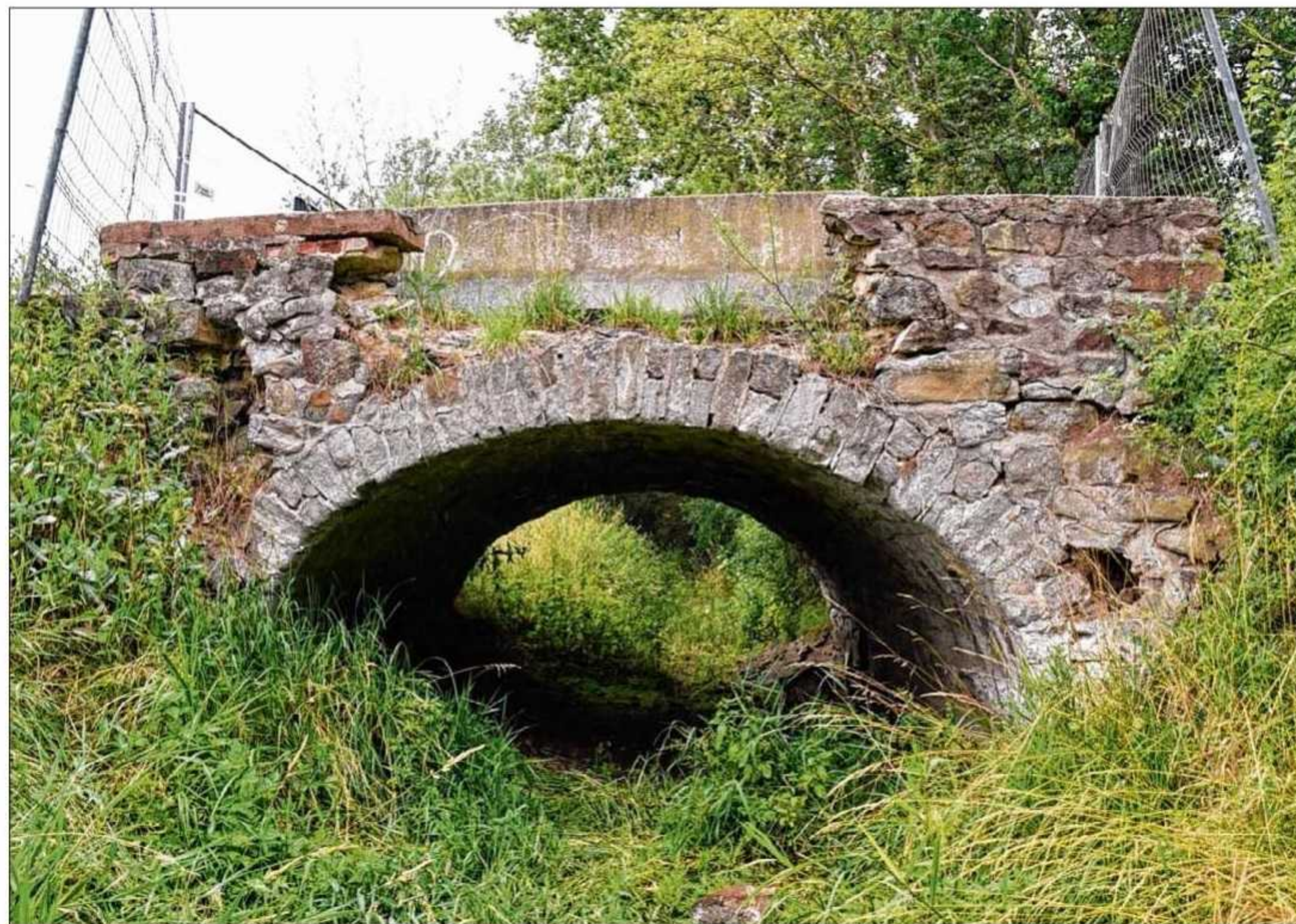
Die Fußgängerbrücke über die Schrote zwischen S-Bahnhof und Strandbad Barleber See ist wegen Einsturzgefahr gesperrt. Jetzt soll eine Behelfsbrücke installiert werden. Foto: Stefan Harter
