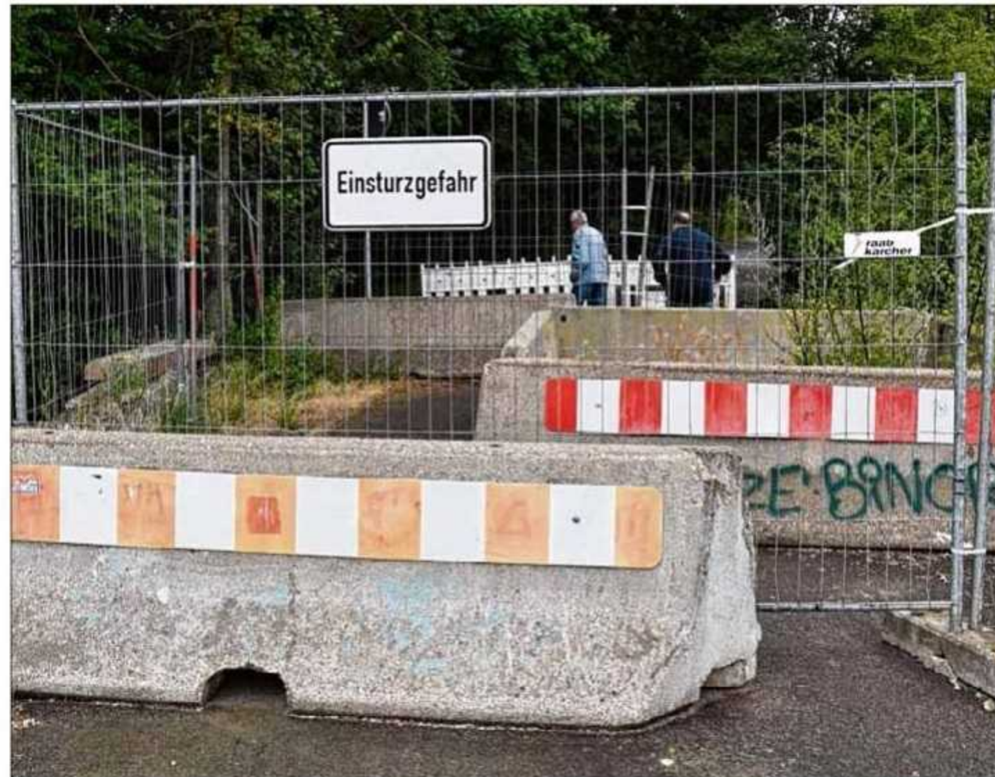
Die kleine Brücke, die südwestlich des Barleber Sees über die Schrote führt, musste wegen Einsturzgefahr gesperrt werden. Foto: Harter
