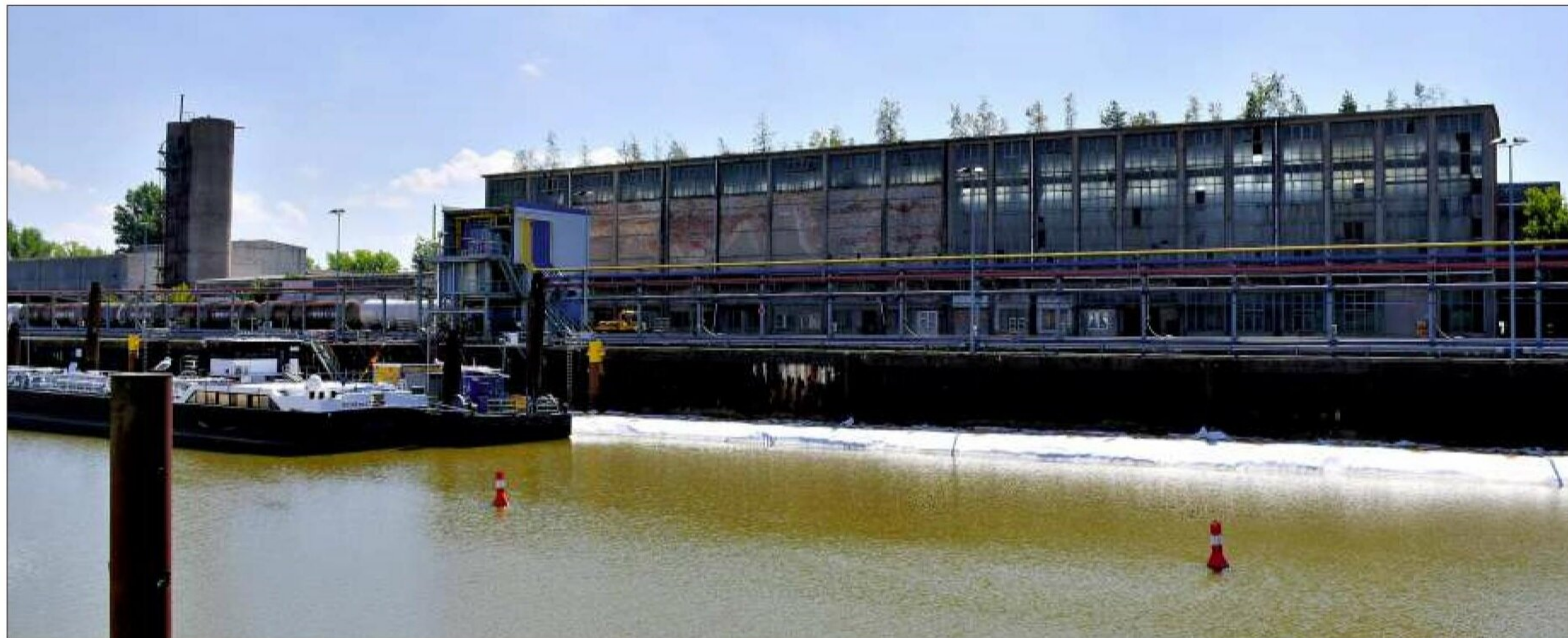
Die Spundwand im Hafenbecken II im Magdeburger Hafen ist akut einsturzgefährdet. Bis der ohnehin geplante Bau einer Ersatzwand beginnen kann, musste nun bereits eine Notsicherung durchgeführt werden.
