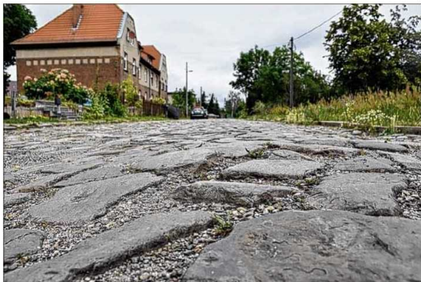
Die Windmühlenstraße in Rothensee soll auf die Warteliste für Fahr- bahnsanierungen.
