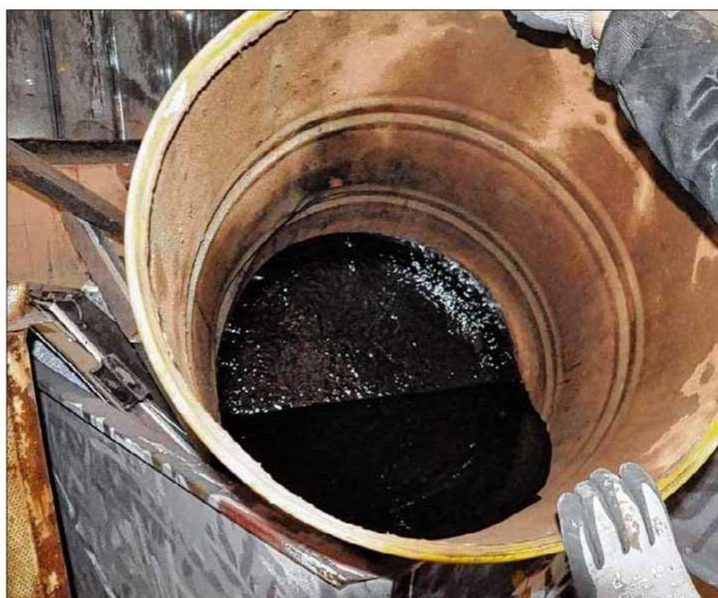
Sogar ein Fass mit Altöl wurde zwischen dem Müll im Becken gefunden.
