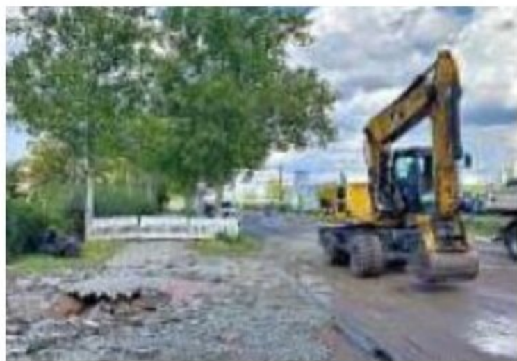
Auf dem August-Bebel-Damm gab es einen Wasserrohrbruch. FOTO: BELLON
