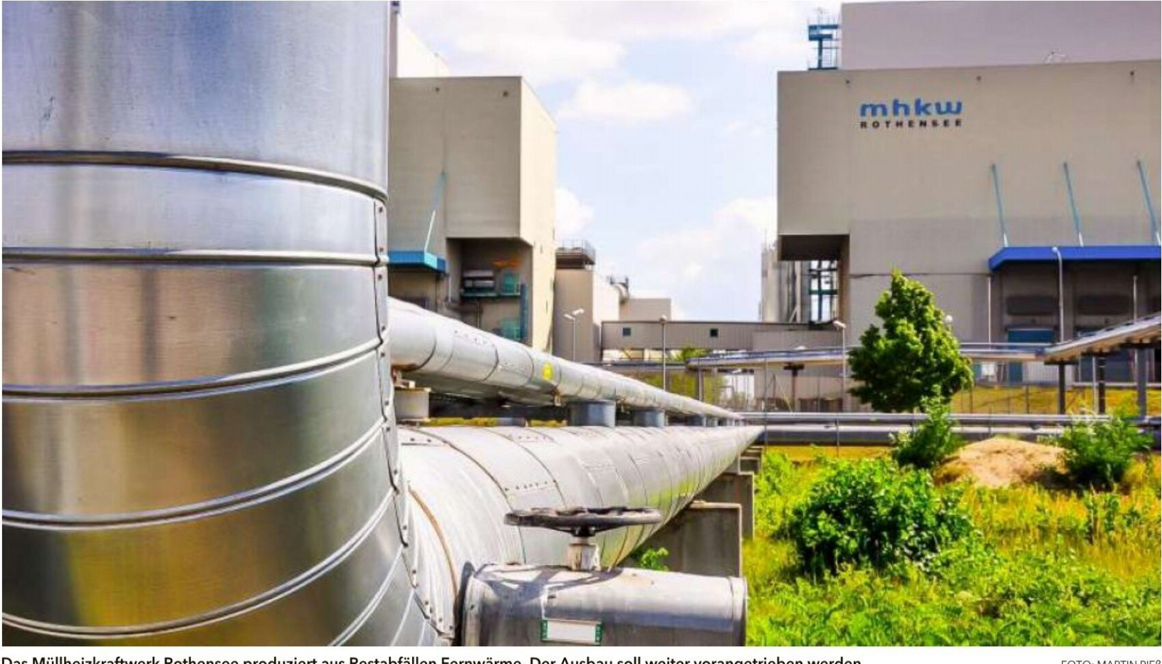
Das Müllheizkraftwerk Rothensee produziert aus Restabfällen Fernwärme. Der Ausbau soll weiter vorangetrieben werden.
